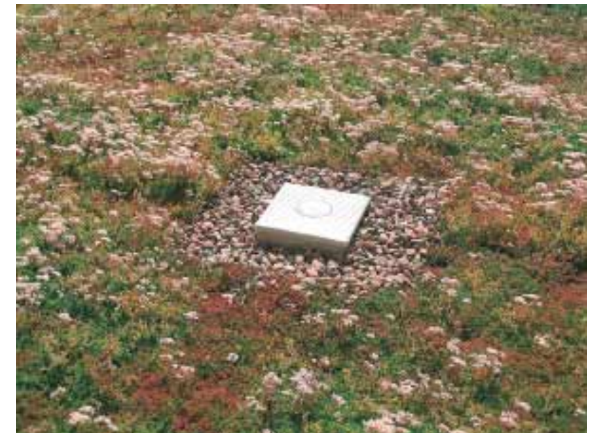
Ein Entwässerungskontrollschacht auf einem extensiv begrünten Flachdach.
